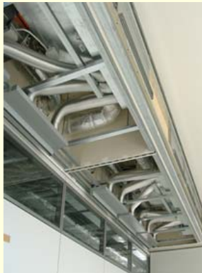
Zu- und Abluftinstallation
